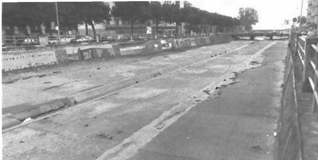
Il Consorzio Bonifica Tronto, nei centri abitati di maggiore rilievo, interviene anche con massicce opere di "bonifica". Infatti vediamo nella foto il prelievamento realizzato "in calcestruzzo" nel tratto terminale del torrente Albula nel centro abitato di S. Benedetto del Tronto.
